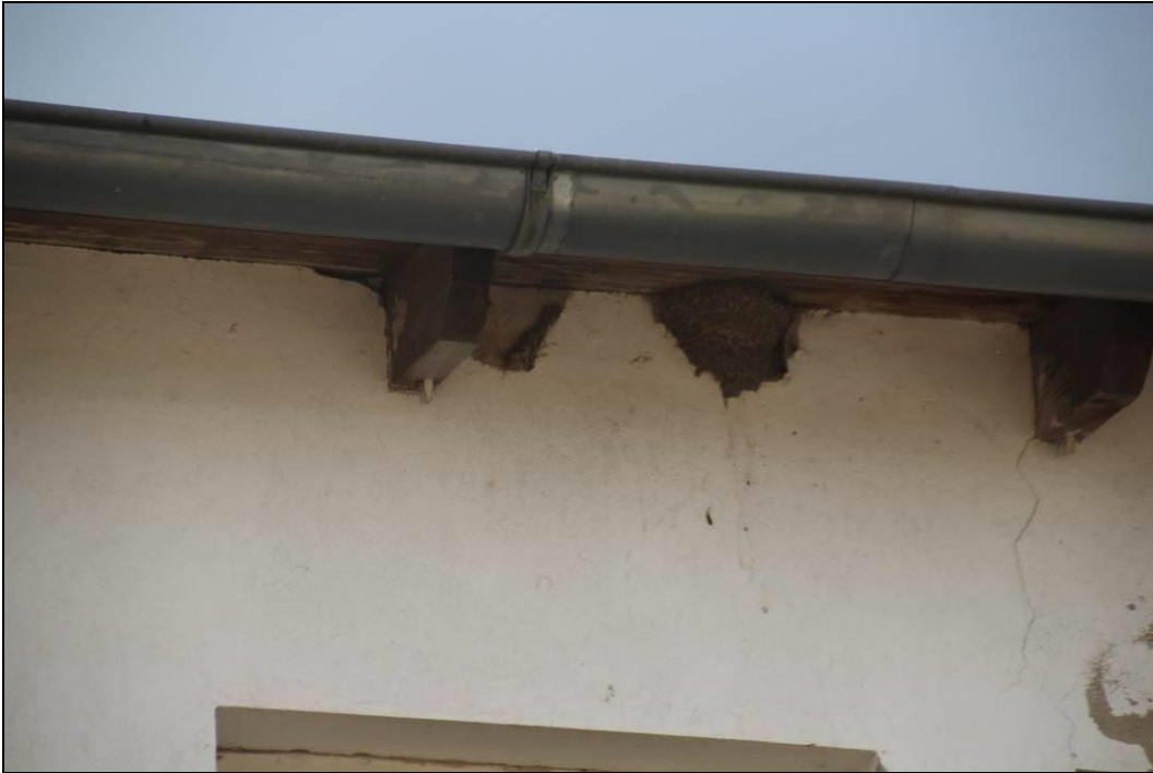
Abbildung 30: Mehlschwabennest an der Ostfassade des Gebäudes 1. Dieses Nest wurde im Jahr 2020 nicht mehr genutzt. Offenbar ist der Prädatordruck zu groß.
