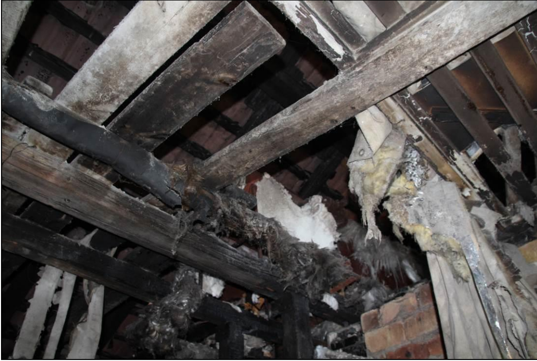
Abbildung 7: Brandschaden im Dachbereich des Gebäudes 1
