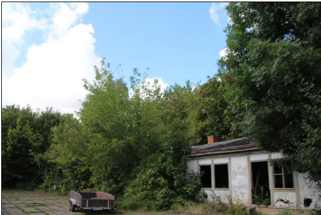
Abbildung 16: nördliche Halle des Gebäudekomplexes 2, die ebenfalls fast vollständig von Gehölzen umwuchert ist
