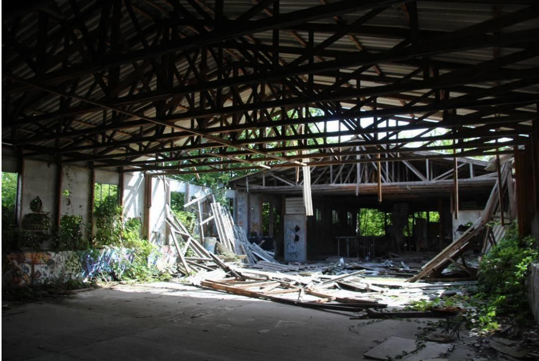
Abbildung 15: eingestürztes Dach einer Halle des Gebäudekomplexes 2
