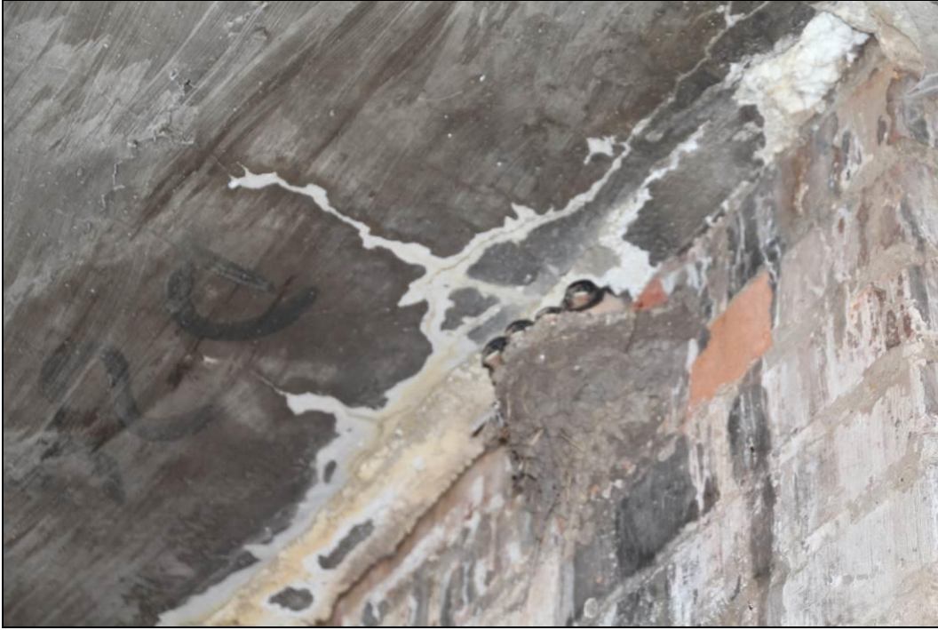
Abbildung 34: Rauchschwalbennest mit Jungtieren im Gebäude 5
